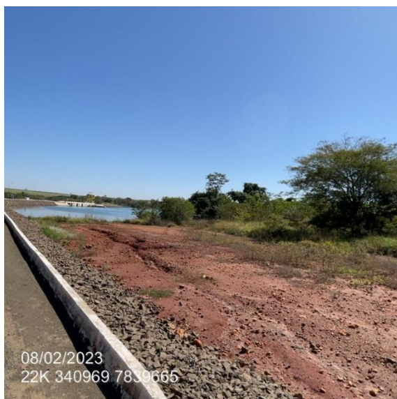
Figura 13.3-2: Início de processo erosivo no entorno das vias de acesso da PCH Bandeirante. Programa de Prevenção e Controle de Erosão e Assoreamento do Reservatório da PCH Bandeirante, Água Clara, MS. Agosto de 2023, formato da data MM/DD/AAAA.
